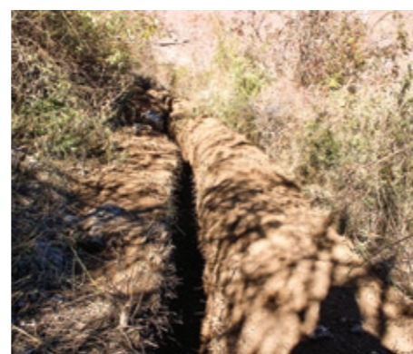
Hier liegt bald die Wasserleitung, die zu den Zapfstellen im Dorf führt.
